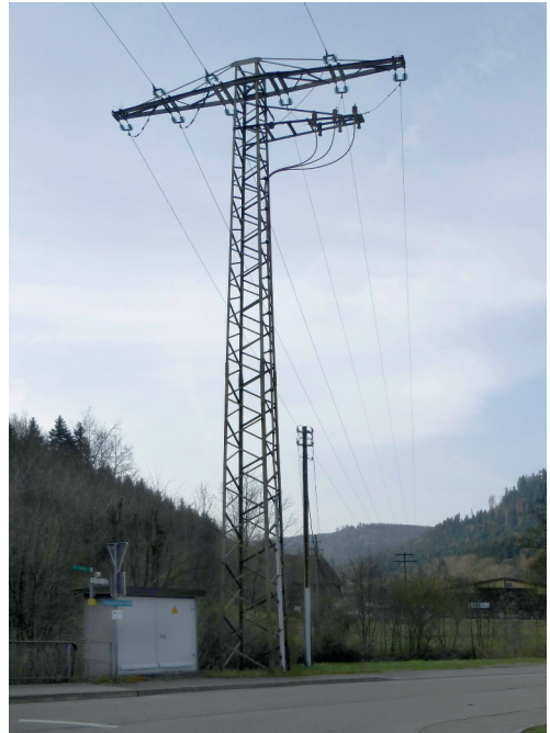
Bad Wildbad – Gittermast 1930er Jahre, daneben Kompaktstation
