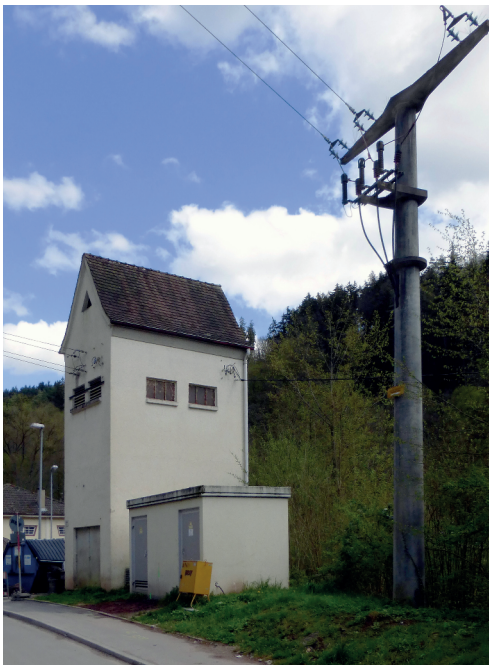
Calw, Trafostation von 1942, daneben moderne Kompaktstation und Betonmast
