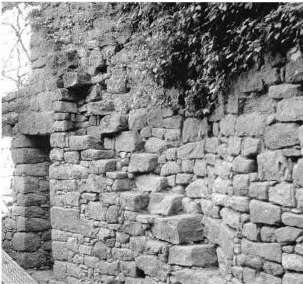
Abb. 19 Im Westzwinger. Das Mauerwerk mit den Treppenstufen, Bild wie zuvor, ist vom Bewuchs befreit, ausgezwickelt und mit noch offenen Fugen.
