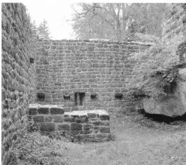
Abb. 14 Der Innenhof mit dem Mauerstummel und Kragsteinen an der Ostwand, nach der Renovierung. Rechts die Palaswand- Außenseite.
