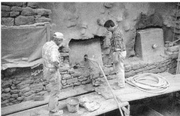
Abb. 11 Am Manometer wird das Fließen des Mörtels durch den Betonquader hindurch überwacht
