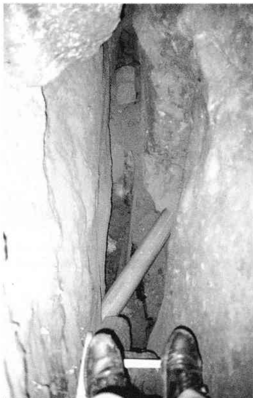
Abb. 13 Blick nach unten auf das Rohr um den Felsanker im Hohlraum einer von mehreren Felsspalten.
