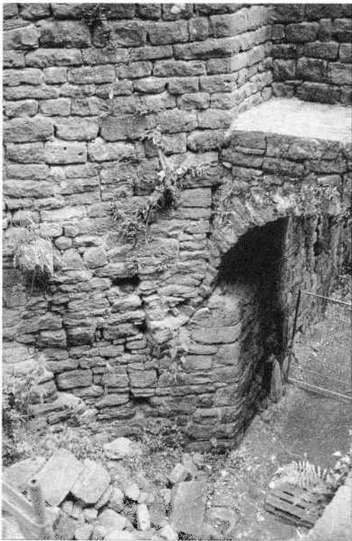
Abb. 23 Linkes Gewölbeauflager des Torturms, das nicht passt. Kragstein Mitte ganz links, darunter unten links vorstehende Mauer, der das Fundament fehlte. War das Gewölbe früher tiefer für ein zweites Tor? Oben Mitte könnte sich der Durchschlupf befunden haben.
