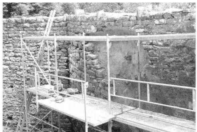
Abb.8 Heruntergefallene äußere Mauerwerksschale hinter dem Gerüst.
