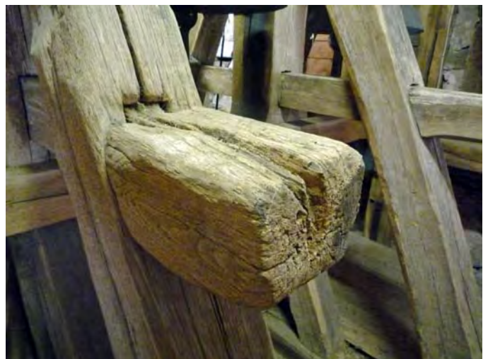
Witterungsspuren am Neuweiler Glockenstuhl Foto: Klaus-Peter Lüdke
