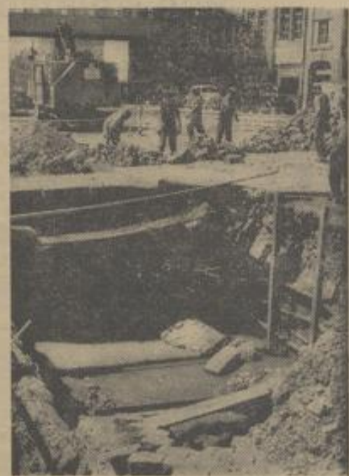
In der Unteren Bachstraße in Stuttgart ist am Dienstagnachmittag das Gewölbe des eingedolten Nesenbachs eingebrochen. Die Einbruchsstelle ist etwa 10 Meter lang und 4 Meter breit. Die Ursache des Einsturzes waren Grabarbeiten am Rand der Straße, bei denen anscheinend das Stützgewölbe versehentlich angeschnitten wurde. Bild: dpa
