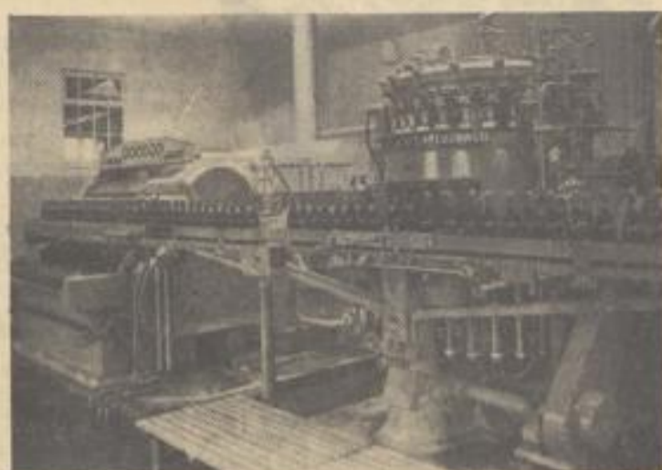
Flaschenreinigungs- und Abfüllanlage
