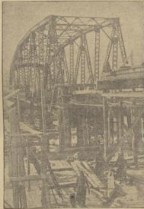
Unsere Pioniere können alles. Als die Sowjets ihren Rückzug antreten mußten, sprengten sie auch diese eiserne Straßenbrücke. Jetzt sind unsere Pioniere dabei, die Bögen zu heben und die Brücke wieder inhand-zuführen. V.R.-Aufnahme: Kriegsberichterstatter Weibel (Sb.)
