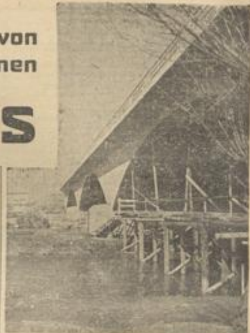
Die Brücke über den Neckar ist fertig — in diesen Tagen fällt das letzte Gerüst
