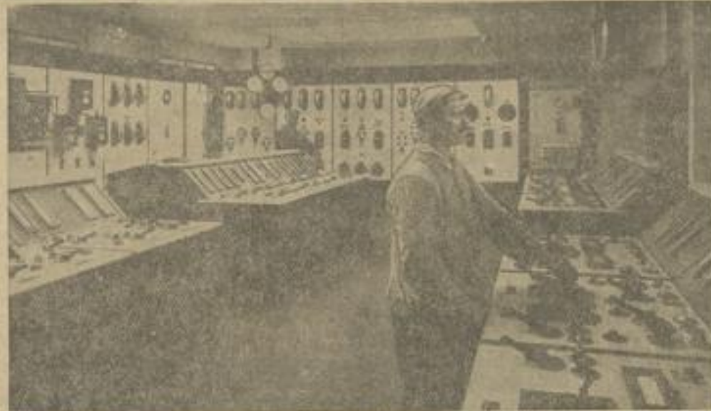
Ein Mann und 200 000 PS . . . Schaltanlage eines modernen Elektrowerkes
