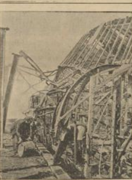
Der ausgebrannte Güterbahnhof von Halle
