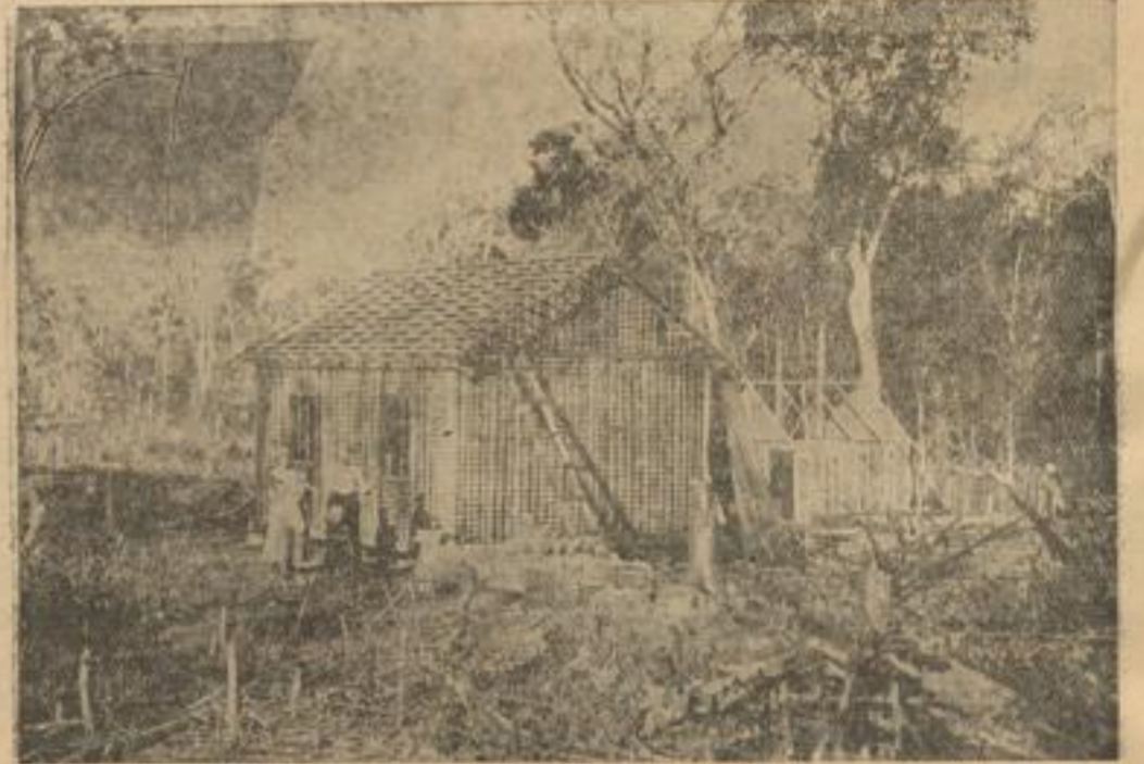
Schwäbische Kolonisten beim Bau ihres Hauses in der Kolonie „Suevia“ in Sao Paulo
