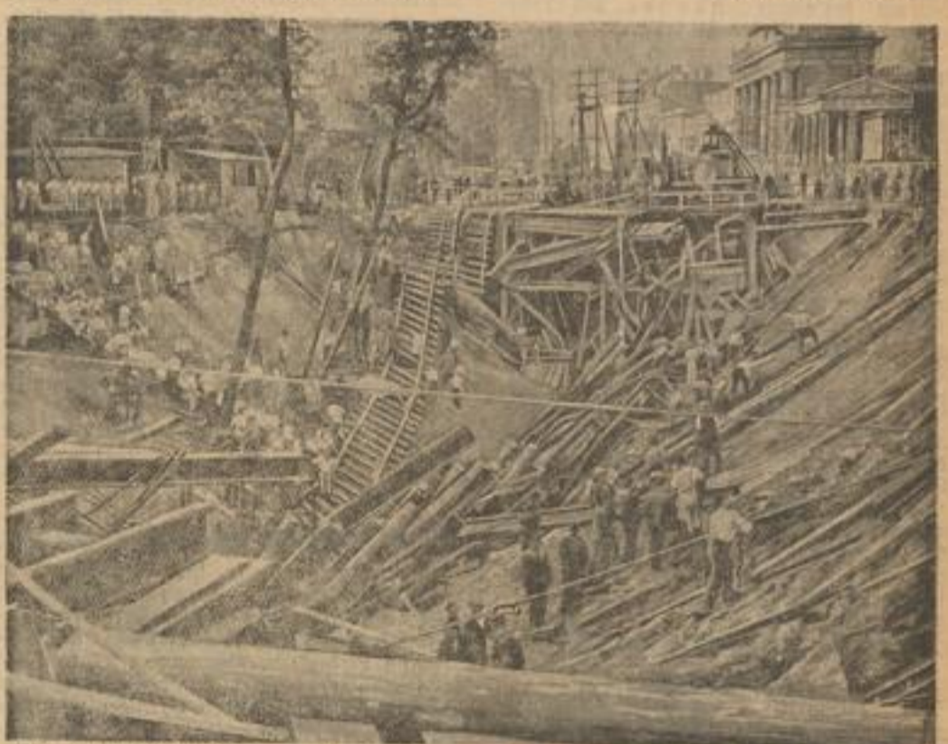
Die Aufräumungsarbeiten am Brandenburger Tor, wo der neue Tunnel der in Bau befindlichen Berliner Nord-Süd-S-Bahn in einer Länge von 60 Meter einstürzte, erwiesen sich als außerordentlich schwierig, so daß es noch längere Zeit dauern wird, bis die Tunnelsohle des eingestürzten Schachtes freigelegt ist. — Das Bild zeigt mehrere Kompanien Pioniere, die im ständigen Schichtwechsel mit der Beseitigung der Trümmer beschäftigt sind. (Wespa-Bild-Service)
