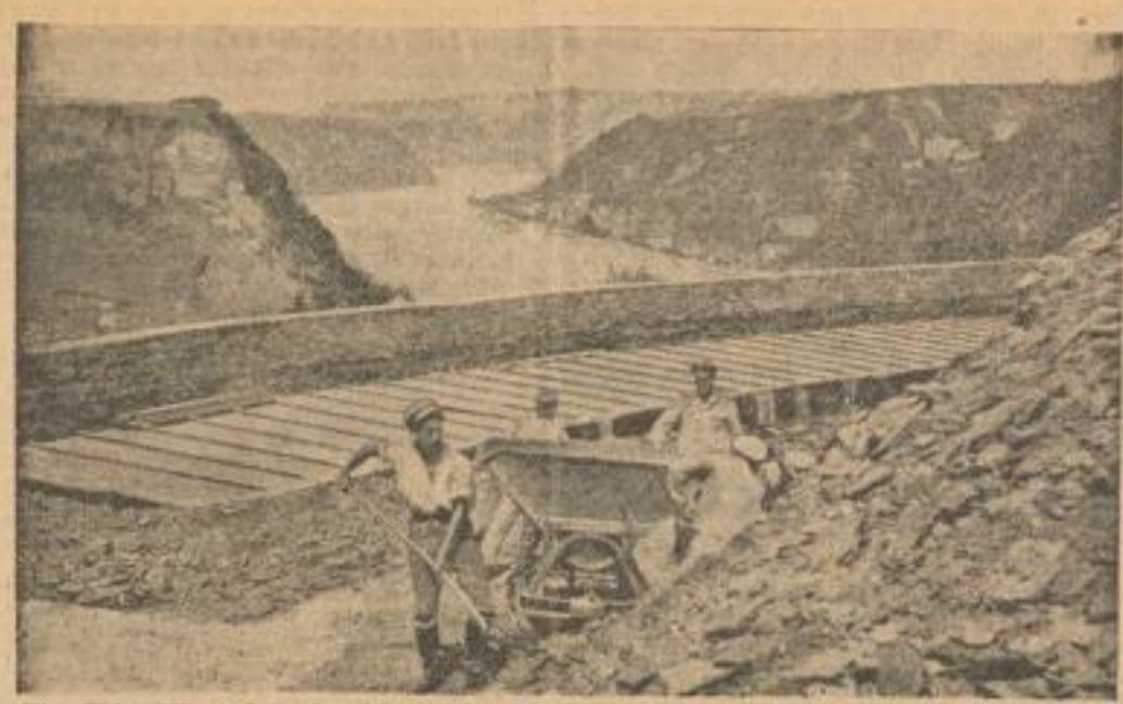
Ein Thingstätte auf der Lorelei. Auf dem Loreleifelsen ist zur Zeit der Arbeitsdienst mit dem Bau einer Thingstätte beschäftigt, die eine der schönsten Deutschlands zu werden verspricht
