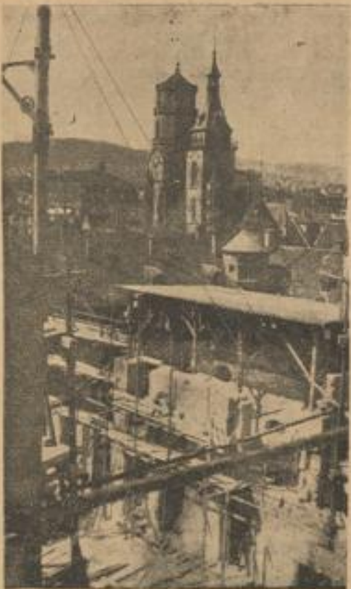
Blick vom höchsten Gerüst über den ausgebrannten Ostflügel. Im Hintergrund die majestätischen Türme der Stiftskirche
