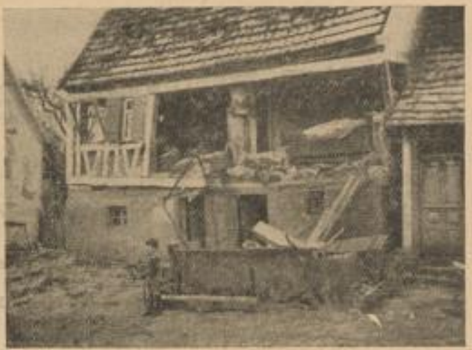
Das Haus des Bauern Michael Koller nach der Explosion am letzten Mittwoch. Nach den inwärtigen erfolgten amtlichen Ermittlungen soll eine — Wärmeblase die Ursache dieser verheerenden Explosion gewesen sein. Man rechnet sogar mit dem Abbruch des Hauses.
