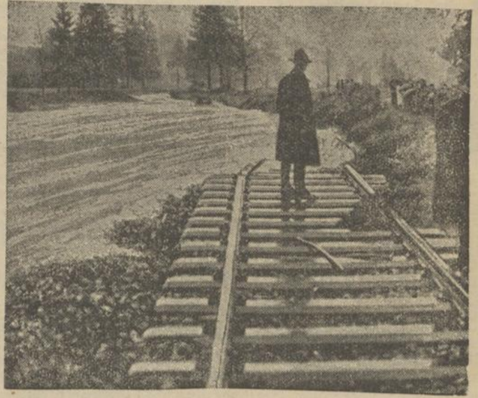
Unterspülter Eisenbahndamm auf der Strecke Goslar—Clausthal
